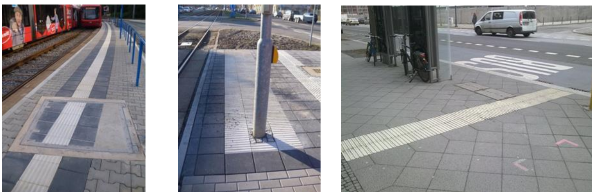
Abbildung 6: Visuelles und taktiler Leitsystem aus kontrastreichen Bodenindikatoren
